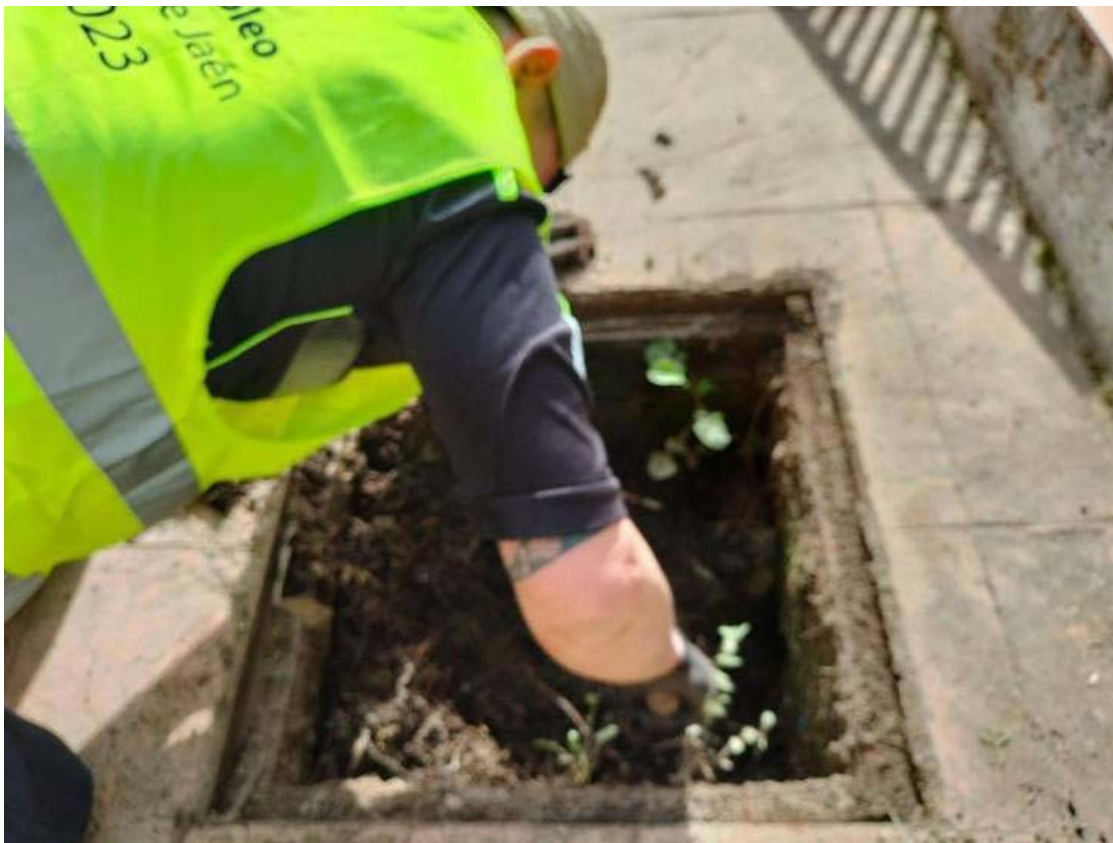
Un empleado limpia un imbornal. / Ayuntamiento de Jaén
