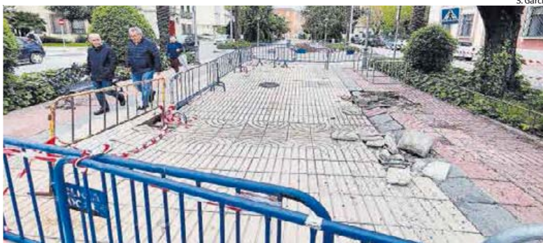
Parte del bulvar de la avenida de Huelva que se ha hundido, vallado.
