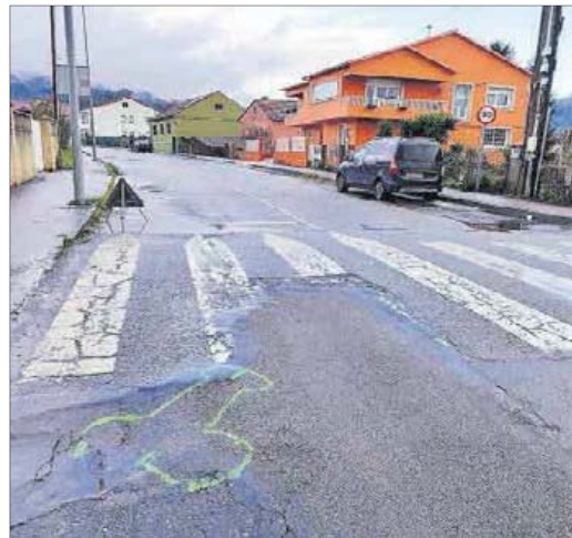
Los hundimientos en la vía fueron señalados de esta forma en la vía.
