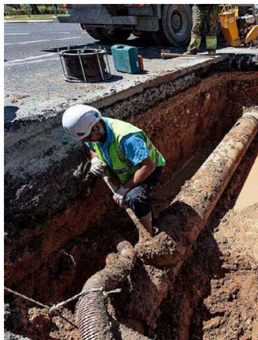
Un operario intenta arreglar una fuga de agua. / O.H.F.
